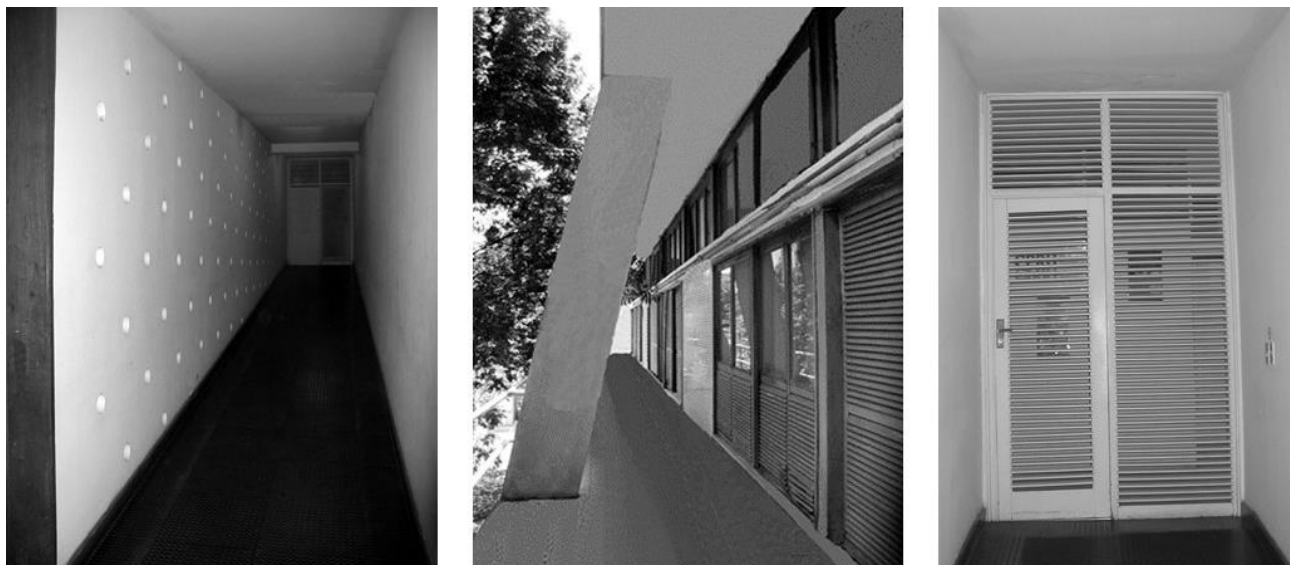
Figura 16: Peles em buzinetes da parede da rampa, e panos de esquadrias de madeira com vidro, corredeiras presentes na varanda dos quartos, no pavimento superior.
